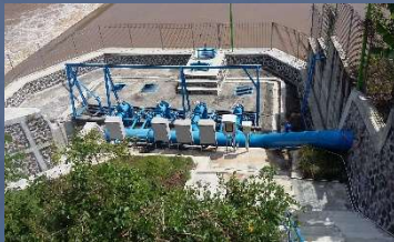
Jaringan Pipa di Intake
